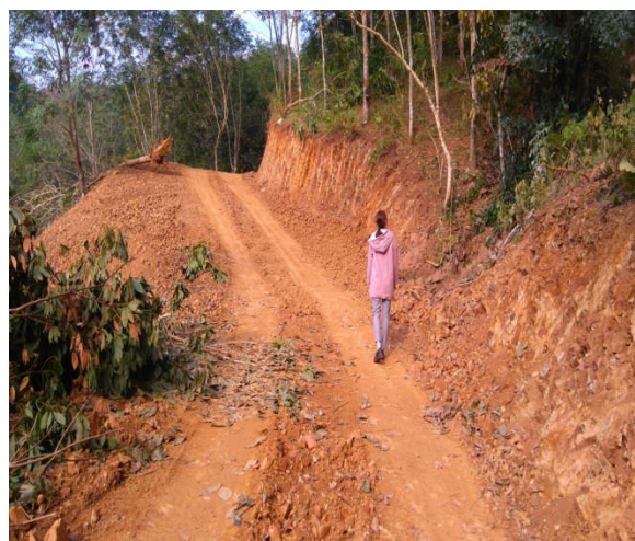
Đường VC không đúng tiêu chuẩn
